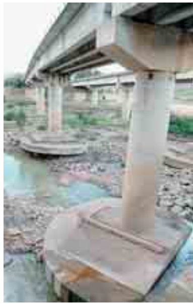
IL CEDIMENTO DEL VIADOTTO HIMERA
